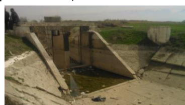
Рисунок 7 не функционирующее-перегораживающее сооружение
